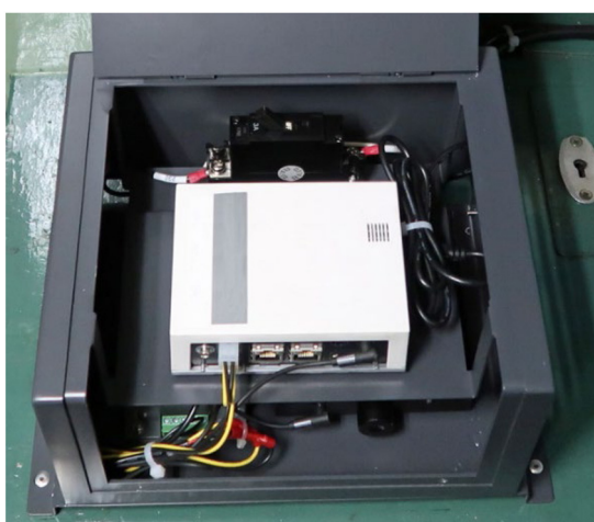
図2 据置型忌避音装置の設置状況（箱内部の上段に小型PC、下段にアンプとDC-DCコンバータを配置）
