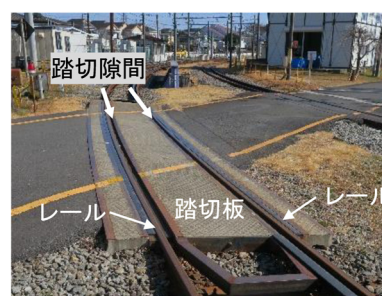
図1 踏切隙間の状況
