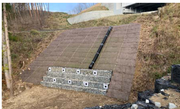
図16 豪雨で崩壊した盛土の復旧事例
