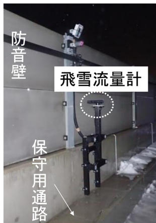
図7 飛雪流量計 SPC の設置状況
