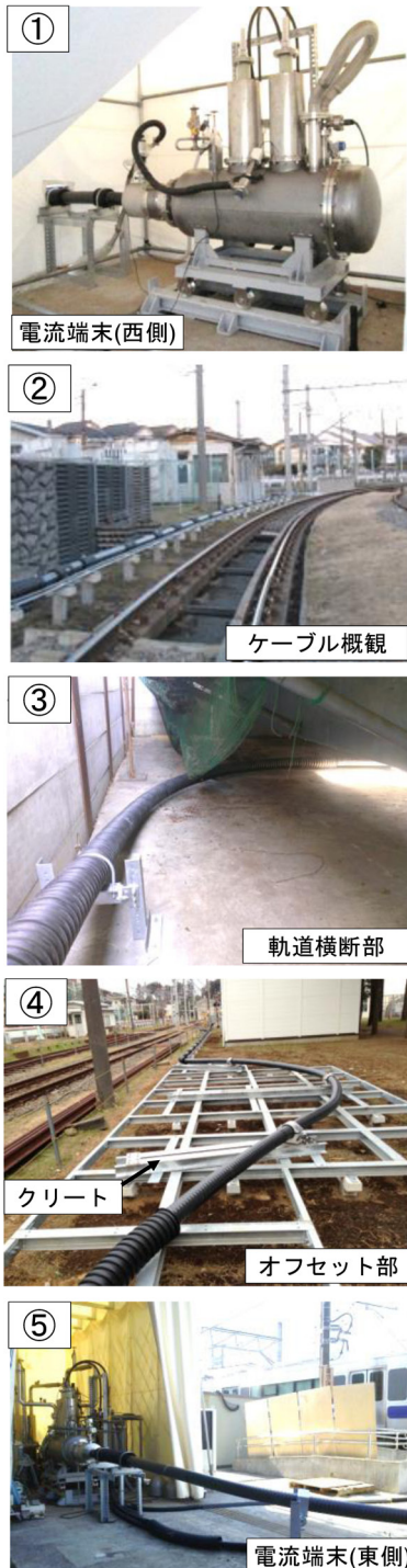
図7 敷設後の300m 級超電導き電ケーブル
