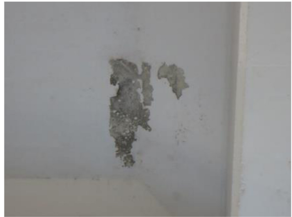
図2 表層剥離の発生状況例
