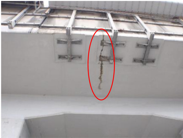
図1 塗膜割れの発生状況例
