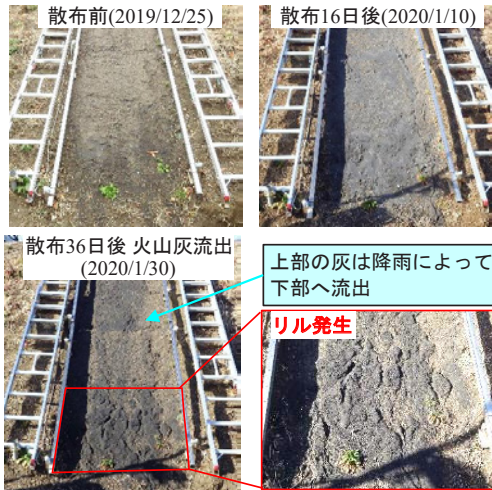
図12 のり面表層の火山灰の状況
