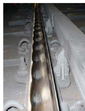
図1 レール波状摩耗の例
