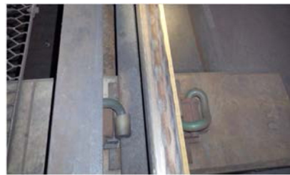
図 15 波状摩耗の外観（営業線 D） (②軌道弾性支床の反共振現象によるその他の例)
