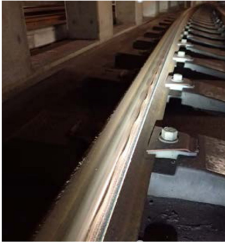
図 16 波状摩耗の外観（営業線 E） （③軌道・車両全体系の反共振現象による例）
