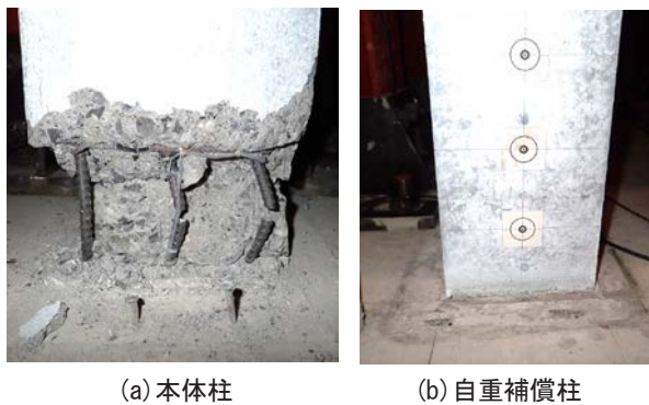
図7 試験後の柱基部の損傷状況（No.15 加振後）
