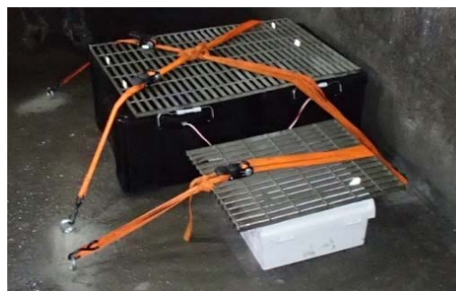
図6 地震計の設置状況
