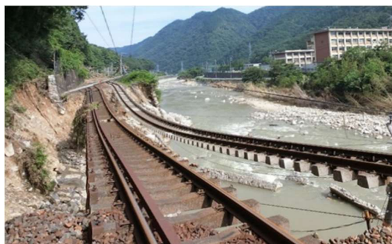
図1 平成30年7月豪雨の被災事例 1)
