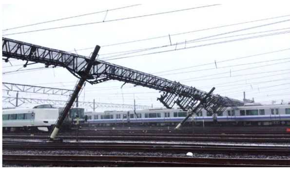
図2 台風21号による強風で倒壊したコンクリート電柱（JR西日本提供）
