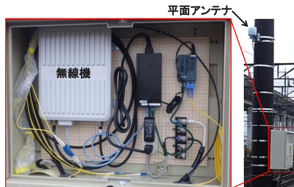
図 5 電化柱に仮設した無線機およびアンテナ
