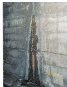
図2 側壁のひび割れから発生する漏水の例
