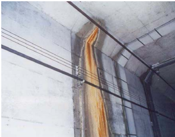
図1 開削トンネルにおける漏水の例
