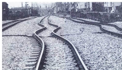
図1 地震時の座屈発生状況の例 5)
