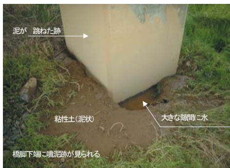
図1 高架橋柱の噴泥痕跡
