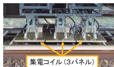
図6 集電コイルの車両床下への設置状況
