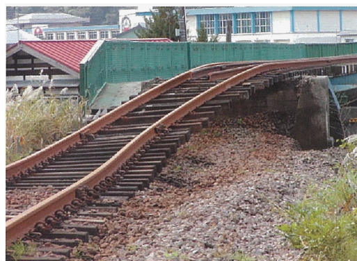
図1 被災事例 1) （新潟県中越地震）
