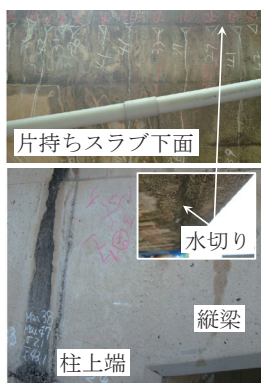
写真 1 滞水跡の状況
