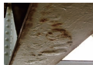
図1 塗膜下腐食の例
