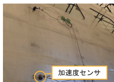
図6 側構体の上下振動測定
