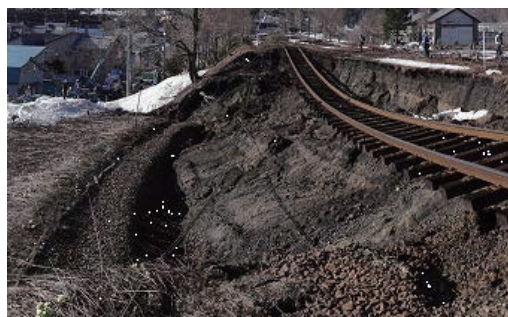
図1 融雪期における盛土崩壊の例
