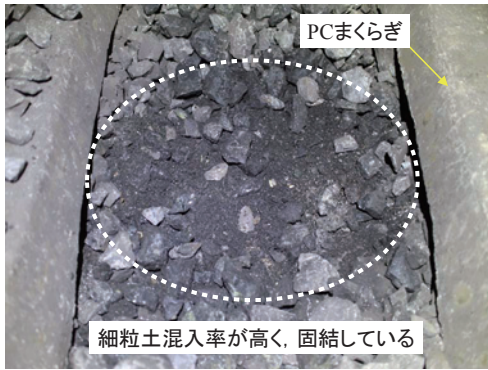
図1 バラスト道床の状況
