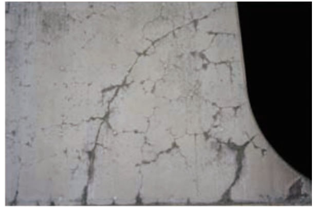
図2 構造物の劣化状況（正面）
