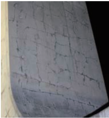
図1 構造物の劣化状況（側面）
