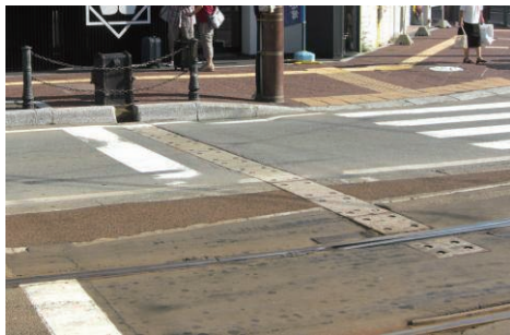
図3 動力転てつ機の設置例 (歩道上)
