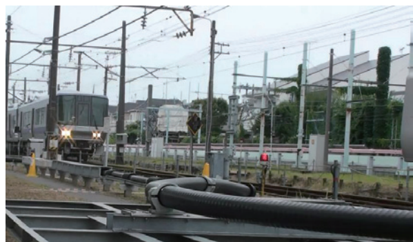
図2 超電導き電ケーブルを用いた列車走行試験
