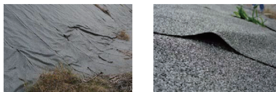
図2 皺，弛み及び剥離の発生状況
