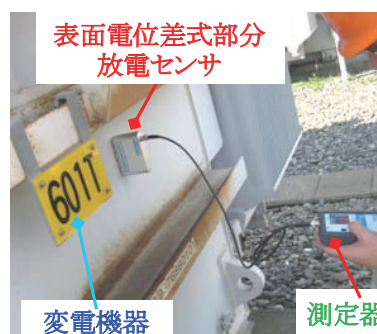
図11 運転中の変電機器における部分放電測定状況
