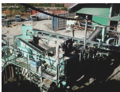
図 5 粒度調整プラント設備
