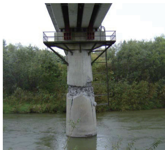
図3 RC橋脚の軸方向鉄筋途中定着部の被害例
