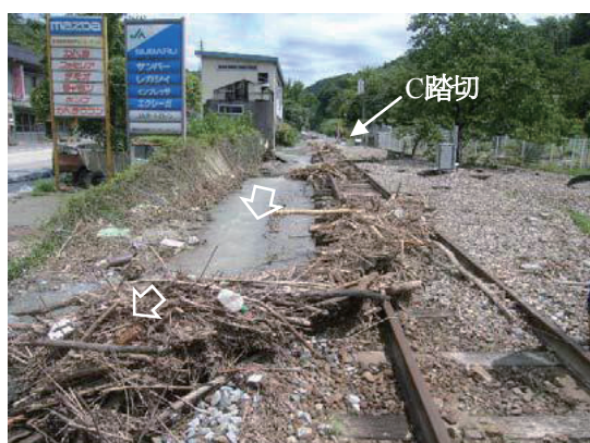
図5 線路外へ流下する雨水（被災直後）
