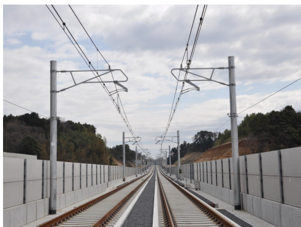
図 10 き電ちょう架式コンパウンド架線
