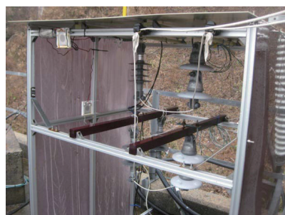
(b) DC1.5kV課電暴露架台 (屋根有)
