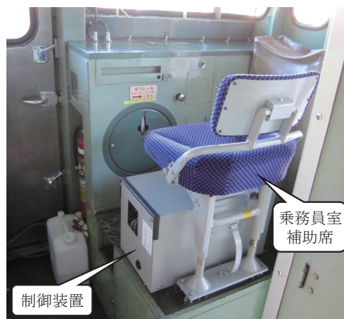
図8 制御装置設置状況
