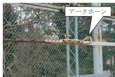
図13 デッドセクション端部のアークホーン
