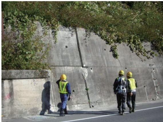
図5 変状が生じたもたれ壁
