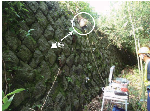
図8 変状が生じた石積壁
