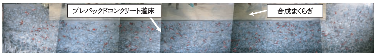
図18 プレパックドコンクリート道床の切断面 ※赤の着色箇所が未てん充箇所
