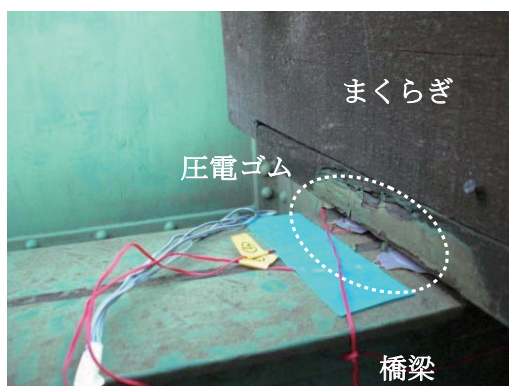
図 11 圧電ゴムの設置状況
