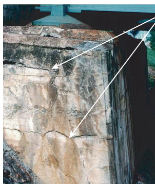
図 1 ASR が生じた構造物
