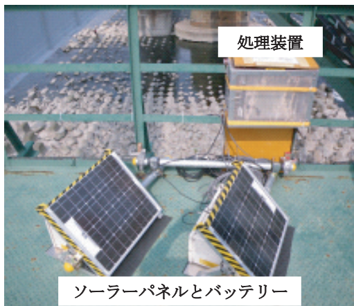
図7 システム設置状況
