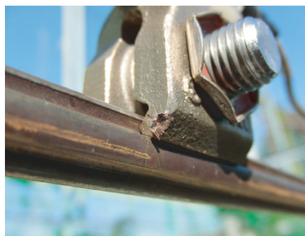
図9 段付摩耗すり板によるイヤーへの打痕およびトロリ線側面への傷
