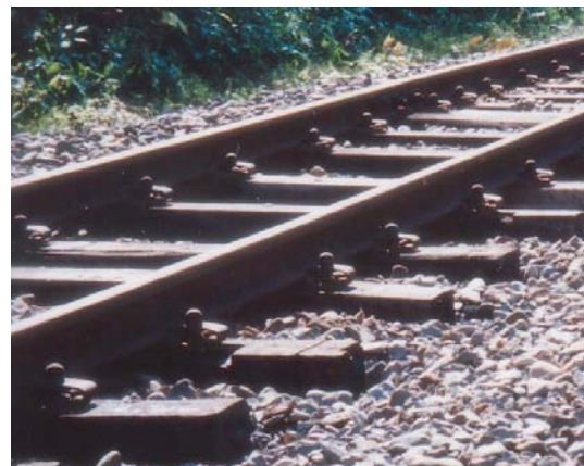
図2 地震後の道床バラスト状況の例
