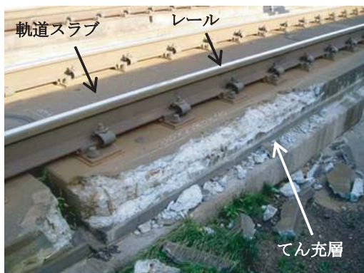
図1 寒冷地での軌道スラブの劣化状況例
