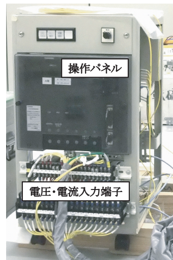
図8 長距離き電保護継電器の外観
