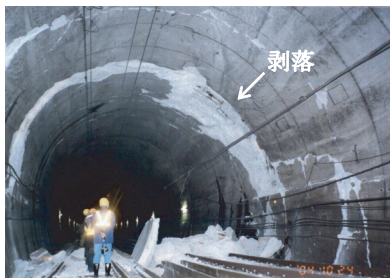
写真3 魚沼トンネルの被害 (中越地震) 3)
