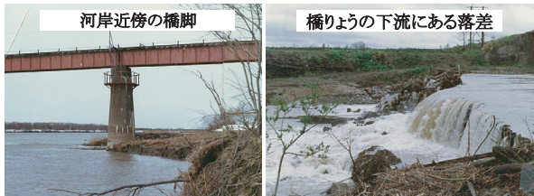
図1 洗掘災害事例からみた特徴の例
