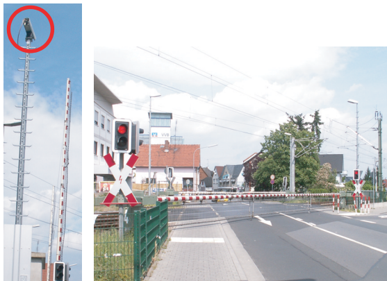
図3 モニタ監視付き全しゃ断踏切
