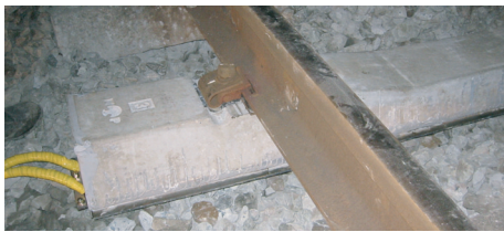
図4 実軌道での設置状況
