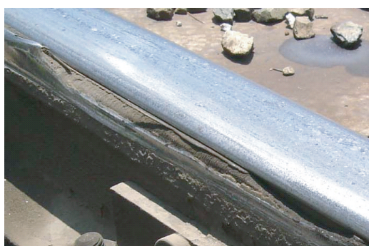
図5 トングレール先端部付近の摩耗状況
