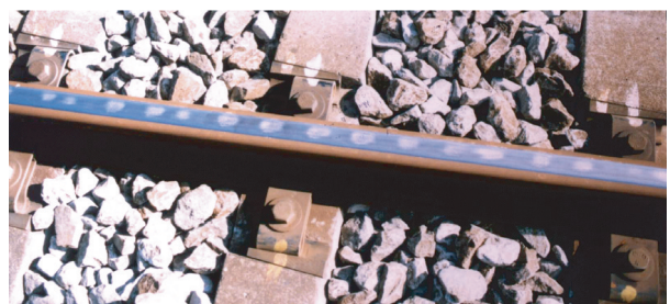
図3 曲線内側レール（内軌）の波状摩耗の例
