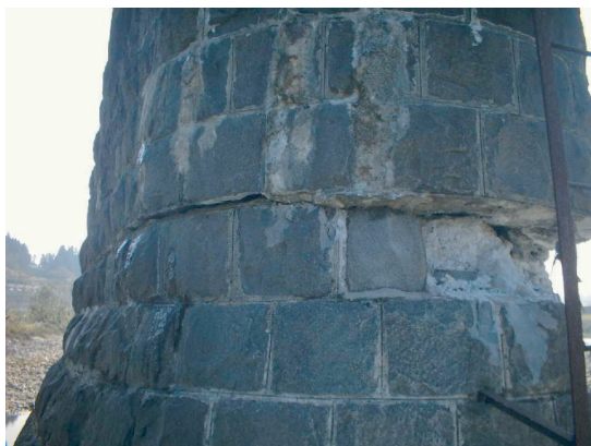
図8 石積み橋脚の断面変化部に発生した変状
